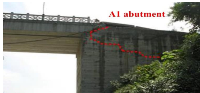
(d) The damage of A1 abutment
